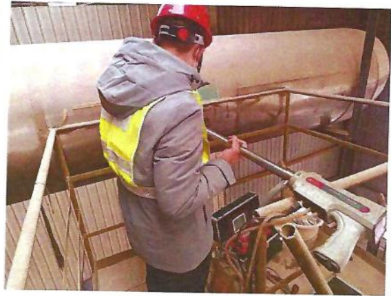
洗涤塔排气筒出口 (©1)
