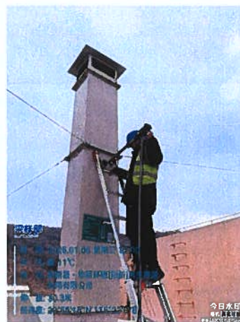
实验室废气排放口
